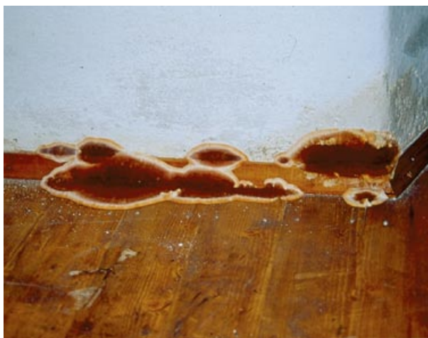
■ Slika 3. Plodišča sive hišne gobe, ki so se pojavila na novovgrajenem suhem podu le nekaj mesecev po neuspešno izvedeni sanaciji
