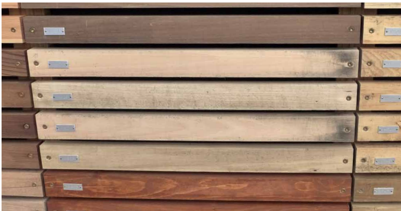
Slika 2: Pojav modrenja na lesenih fasadnih elementih (avtor: Miha Humar)
