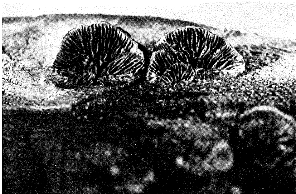
Sl. 20. Trebušna stran trosnjakov gniloživke Gloeophyllum sepiarium (Wulf. ex Fr.) P. Karst. na čelu smrekovega, s katranskim oljem impregniranega električnega droga, ki je bil v 110 kV daljnovodu (5) Divača—Gorjansko—Doblar
