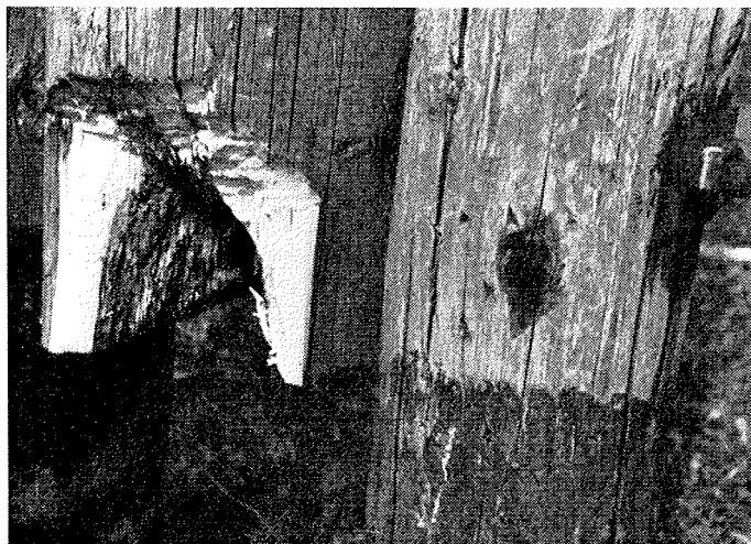
Sl. 8. Smrekov električni drog številka 117, slabo impregniran s ZnCl_2 v 110 kV daljnovodu Brestanica—Rakitje—Zagreb je bil 16 let vgrajen v tleh. V teh letih mu je koreninska goba [ Heterobasidium annosus (Fr.) Bref.] popolnoma razkrojila srce. Sele po 16 letih so strohneli del droga samo delno odžagali in ga ponovno vpeli v smrekove klešče, ki so jih prej impregnirali s katranskim oljem. Klešče so leta 1959 tudi bandažirali
